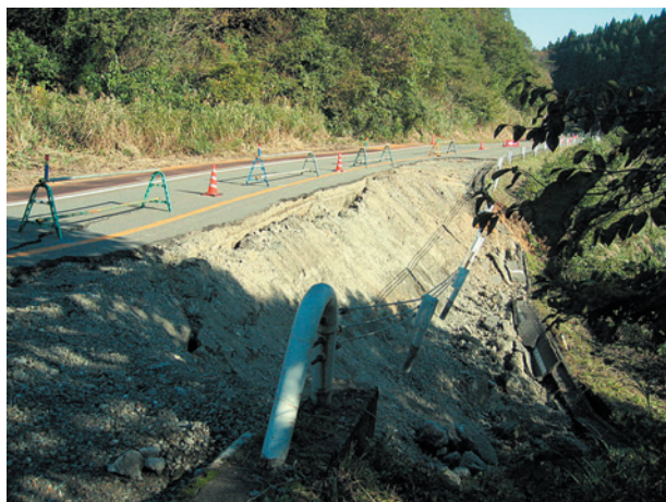
写真-10 道路盛土の崩壊例 (柏崎市)
